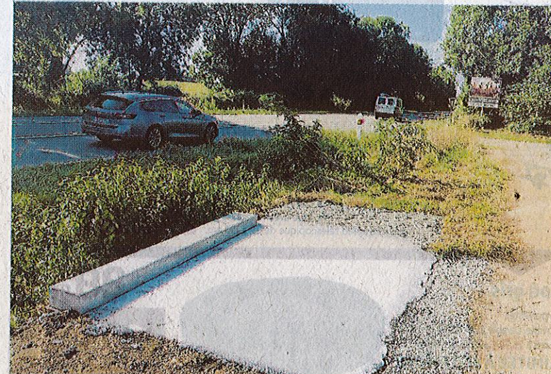
Au moins trois plateformes en béton comme celle-ci sont apparues en août 2024 le long de la trois voies qui relie Parthenay et Niort.
